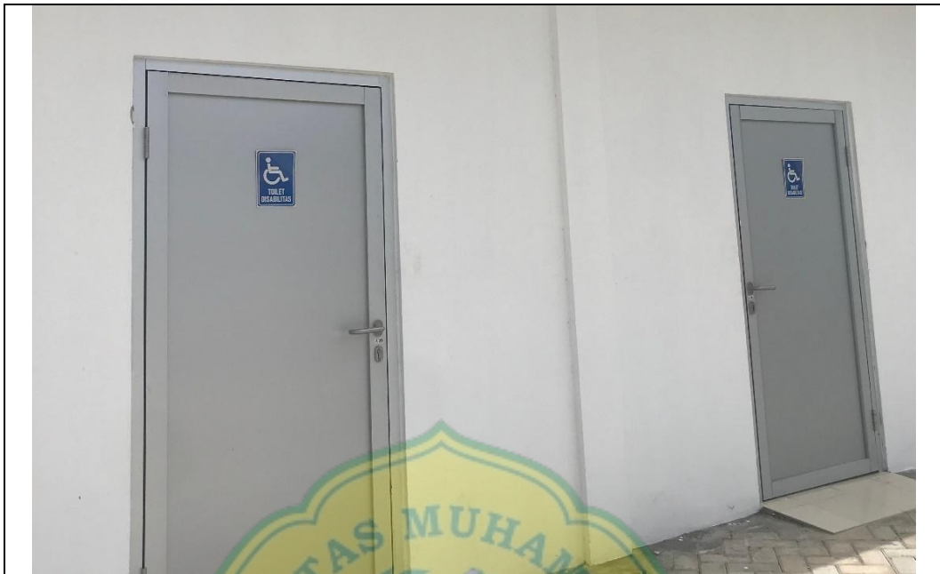
Gambar A .4.3 Toilet Disabilitas Pada Rest Area Km 37b Sumber: Dokumentasi penulis (12 Juni 2025)
