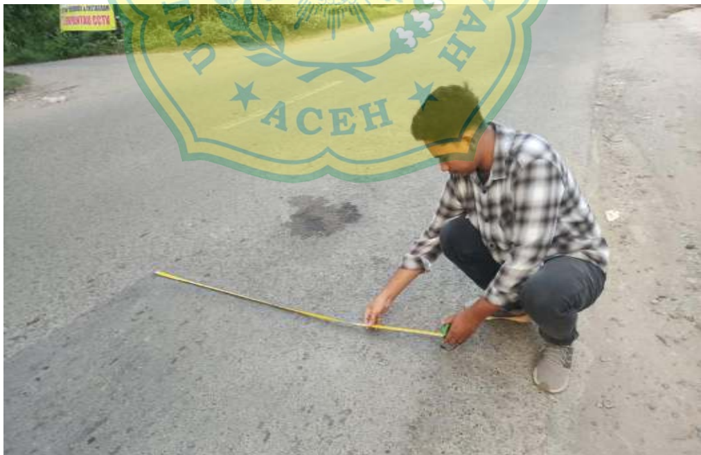
Gambar A.3.6 Proses Pengukuran Kerusakan Tambalan Pada STA 1+700 Sumber : Dokumentasi lapangan , Sabtu 11 Juli 2026
