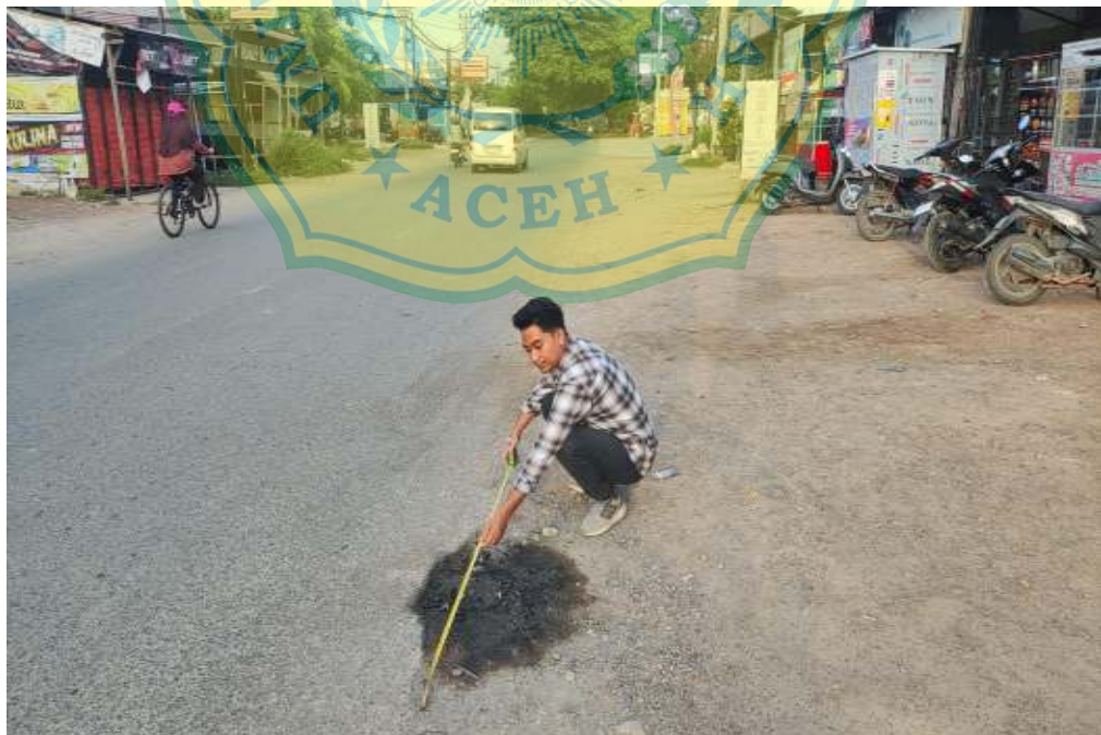
Gambar A.3.8 Proses Pengukuran Kerusakan Retak Tepi Pada STA 2+300 Sumber : Dokumentasi lapangan , 4 Mei 2026
