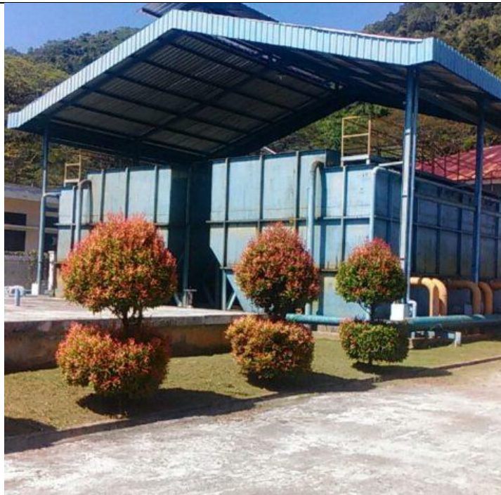
Gambar A.3.7 : Foto Reservoir di PDAM Mountala
