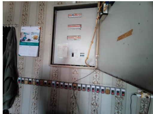
Tombol instalasi otomatis yang ada di dalam kantor
