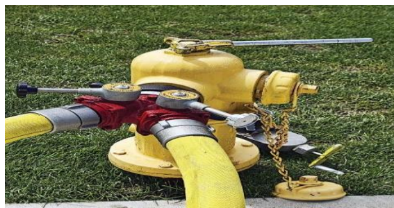
Gambar 6.2 fire hidran Sumber :Dokumen internet 2024
