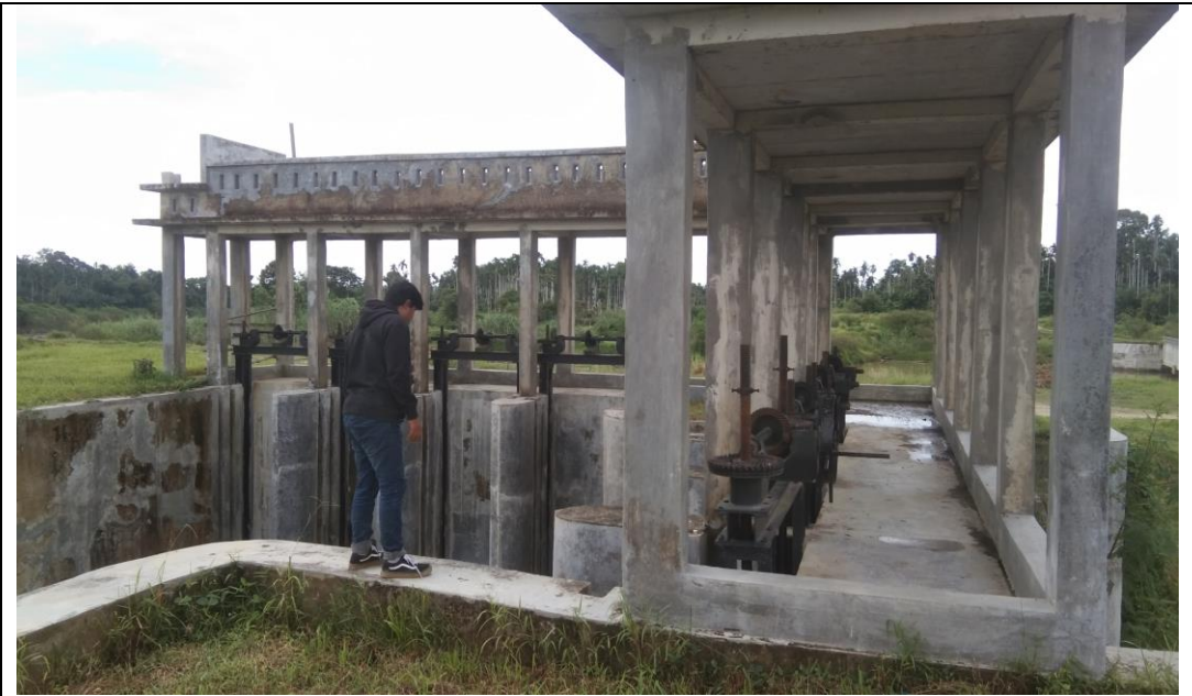
Gambar A.10. Bangunan Sadap Irigasi Jambo Aye.
