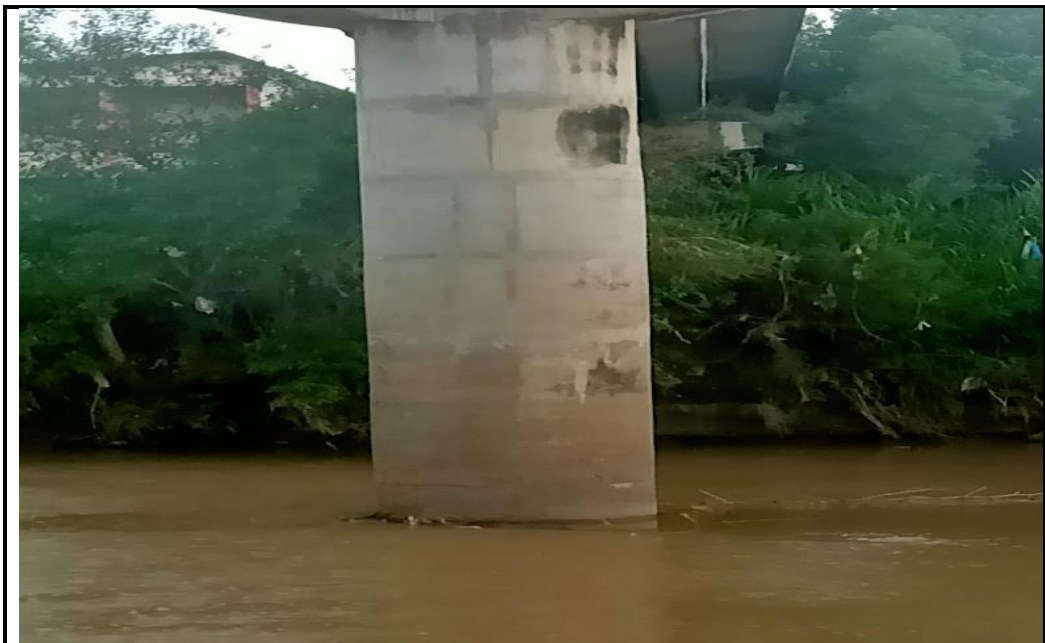
Gambar A.11: Pilar pada sungai yang sudah miring sedikit di akibatkan banjir Sumber : Lokasi Penelitian (2021)
