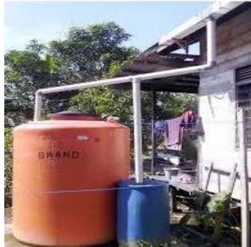
Gambar 4.7 Tangki Penampungan Air Hujan Sumber : airkami.id, 2022
