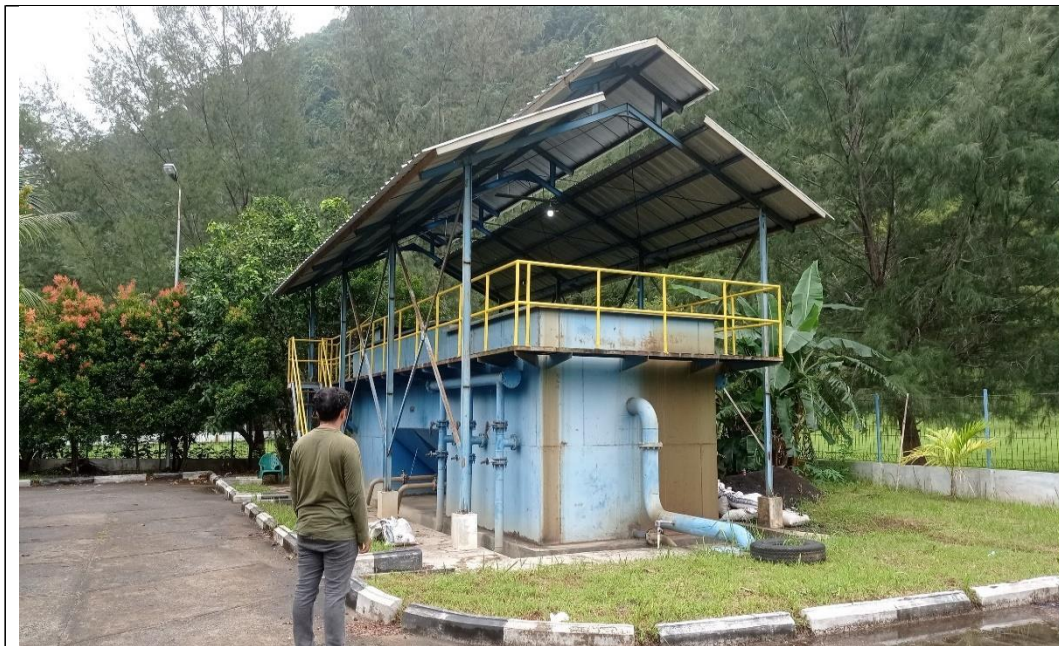
Gambar A.3.8 : Instalasi pengolahan air di Peukan Bada Sumber : Lapangan ( 2 Desember 2023)
