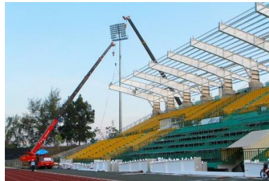
Gambar 5.11 Struktur Baja Girder (Sumber : http://struktursipil.blogspot.co.id , 2021)
