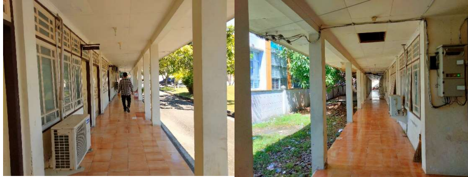
Gambar 2.5 Peletakan Box AC pada selasar Sumber : Dokumentasi Pribadi, 2021
