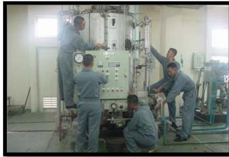
Gambar 2.26 Laboratorium Boiler (Sumber : http://stipjakarta.dephub.go.id , 2018)
