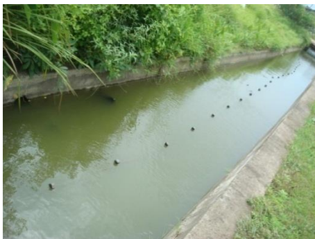
Gambar 4.6: jaringan drainase pada sisi jalan Sumber: dokumen pribadi 2013
