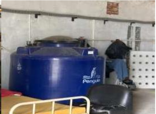
Tangki Penampungan Air
